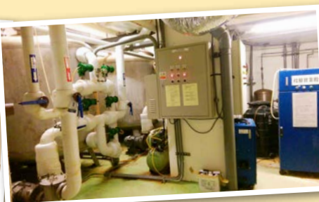
▲ 水質消毒設備
